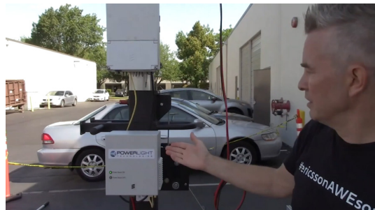
شکل ۱. جعبه توزیع PowerLight در ایستگاه پایه نسل پنجم
